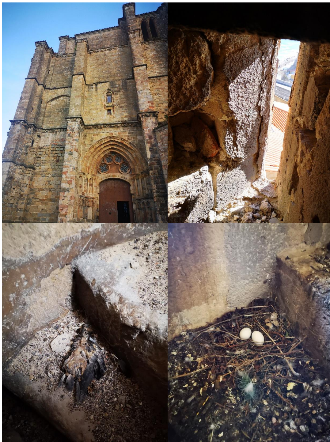
Iglesia de Santa María. Fachada principal, a la izquierda se pueden apreciar las aberturas verticales por donde acceden las palomas al interior de la torre. Detalle de una abertura, detritus y un nido con dos huevos.
