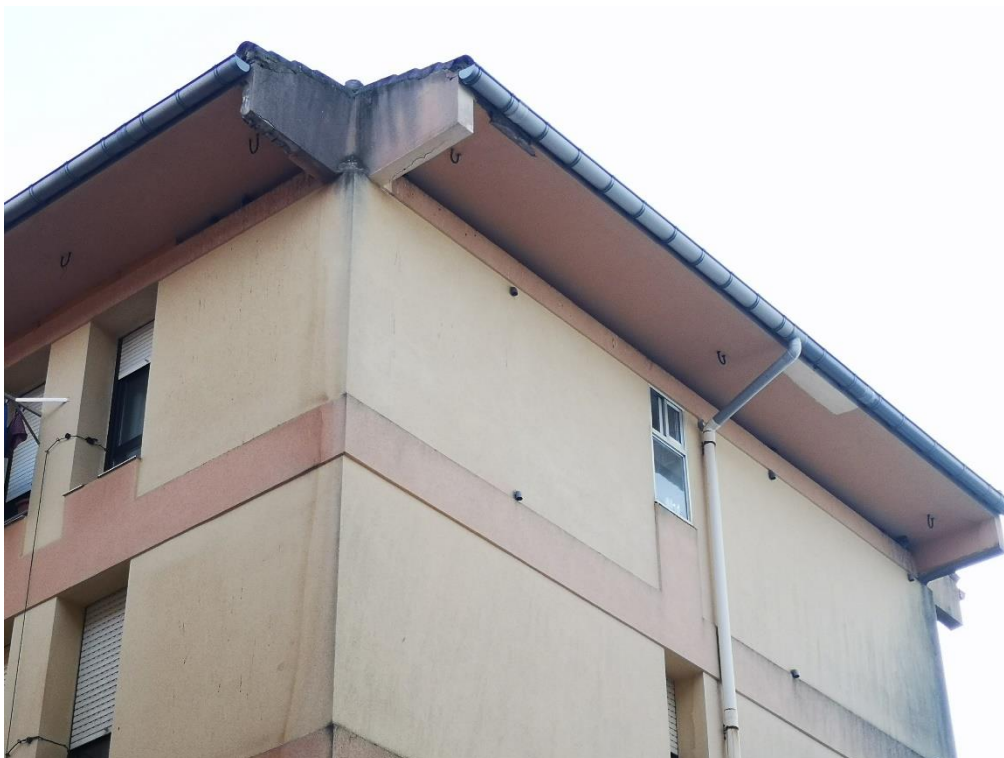
En este y otros edificios contiguos, las palomas utilizan las cornisas como refugio.
